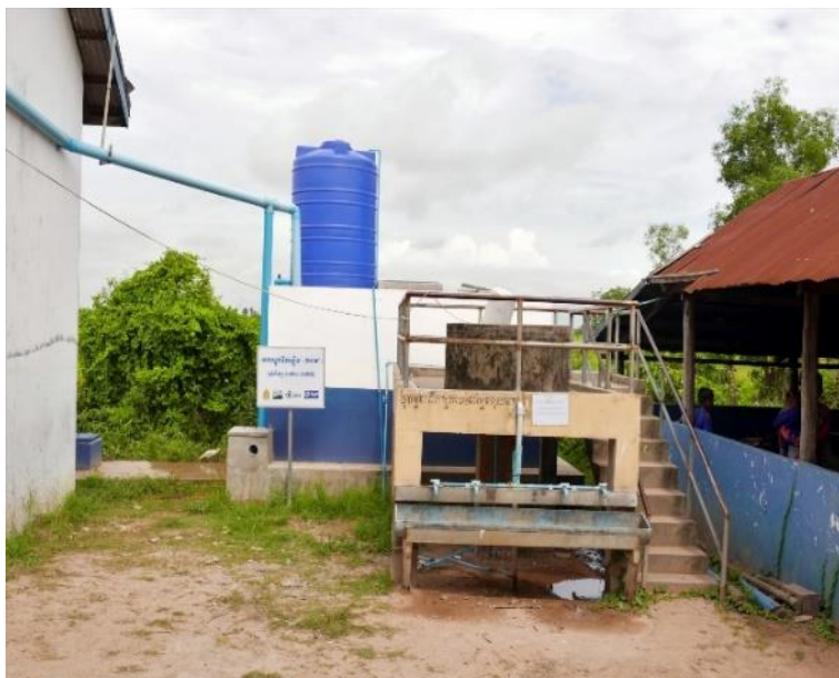
Abb. 12: Ein Kombisystem aus altem Regenwasser-Auffangreservoir, eigenem Brunnen mit Elektropumpe und hier Anlage mit vier Wasserhähnen zum Hände- und Geschirrwaschen.
